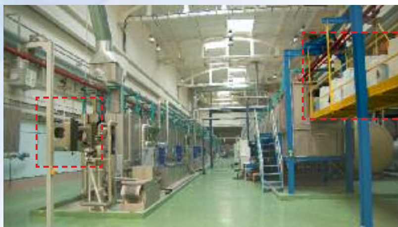
Ejemplo de una línea de pintado de armazones para lavadoras. A la izquierda, el componente previo al pintado; a la derecha, la salida de la pintura para armazones
